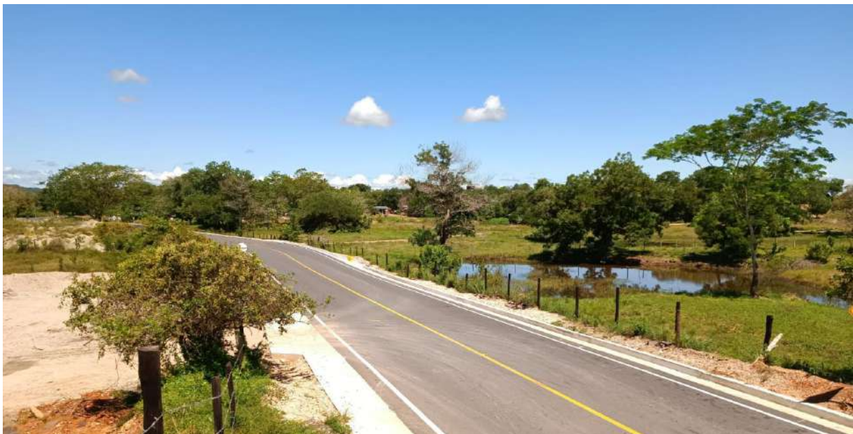
Pavimentación de la vía “Escarralao – El Bagre” Etapa 2. Bajo Cauca, Municipio de Zaragoza. Secretaría de Infraestructura Física.
