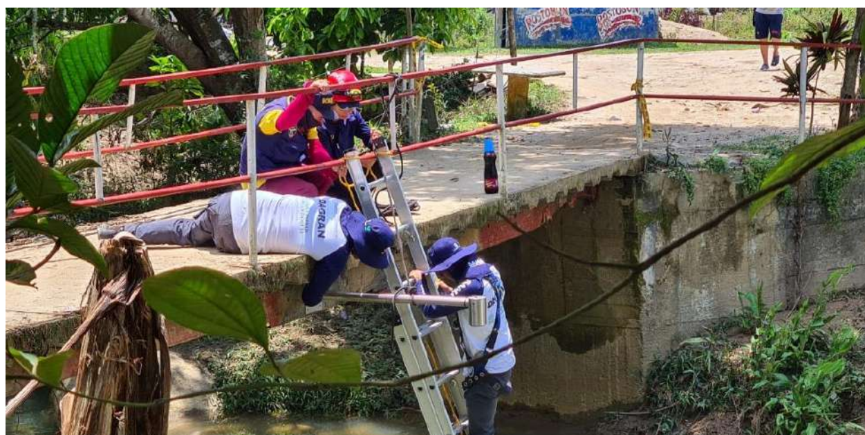
Instalación Sensor de Nivel – Sistema de Alerta y Monitoreo de Antioquia Oriente, municipio San Carlos. DAGRAN
