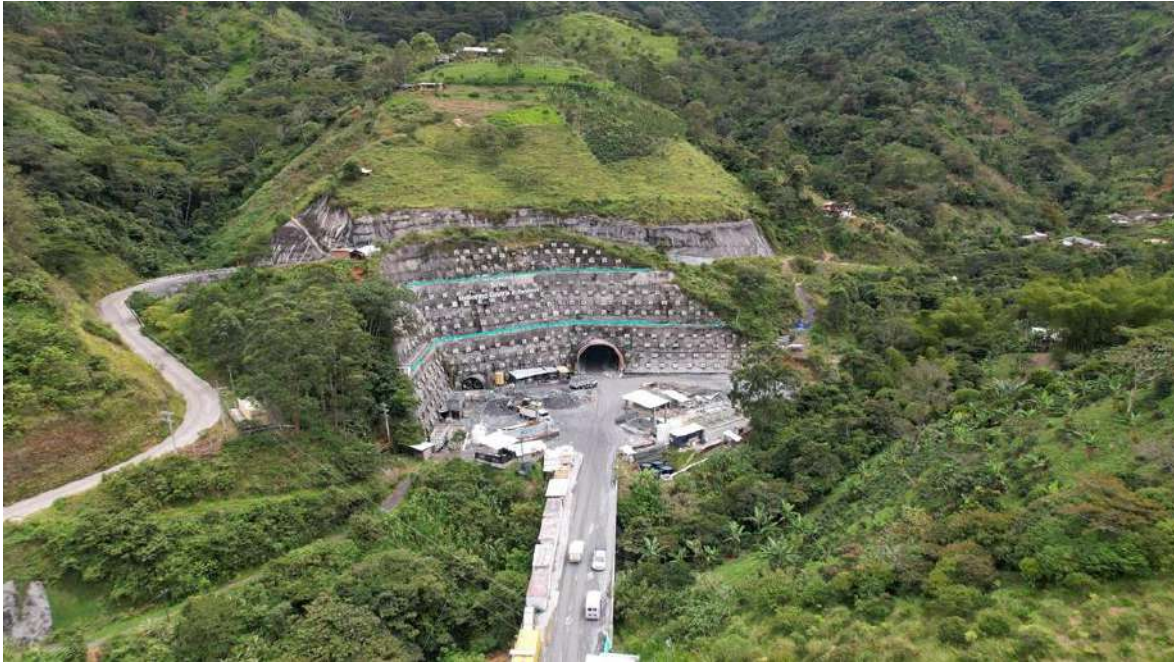
Túnel Guillermo Gaviria Echeverri y sus vías de acceso Portal Salida Túnel Principal Guillermo Gaviria Echeverri (GGE) Occidente, Municipio de Cañasgordas. Secretaría de Infraestructura Física.
