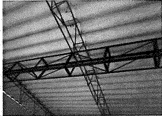
Foto: Estructura sin anticorrosivo.
