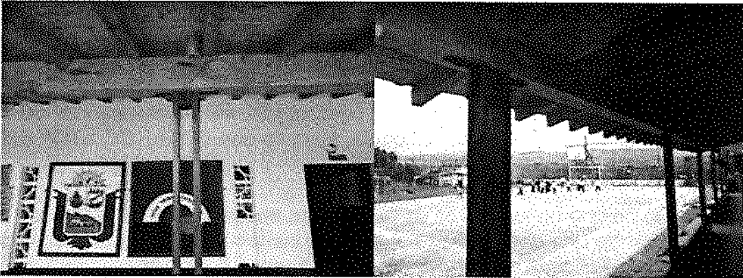
Imágenes 3-4. CER Monseñor Alfonso Uribe Jaramillo, estructura en madera tipo pino y bajantes sin instalar.
